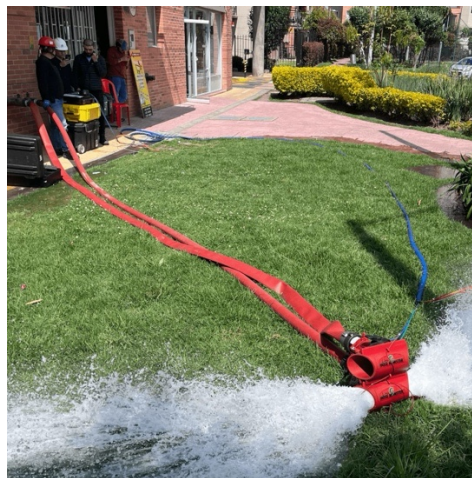
Pruega pitométrica de la bomba contra incendios
