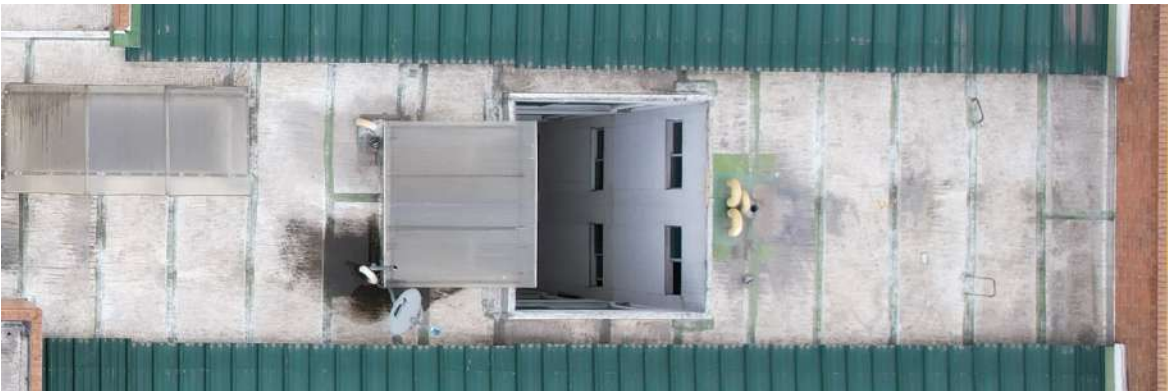
Imagen impermeabilización torres; empozamientos puntuales, desgaste de sello de traslapes, desgaste de protección bituminosa.
