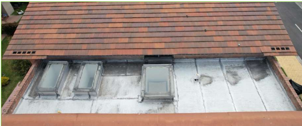
Imagen impermeabilización casa; empozamientos puntuales, desgaste de sello de traslapes y desgaste de protección bituminosa.
