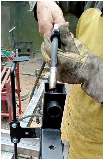
En marzo se realizó la soldadura de reparación y refuerzo de una pieza de la multifuerza del gimnasio
