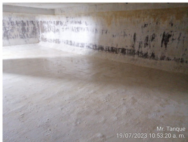
Mr. Tanque 19/07/2023 10:52:47 a. m.
